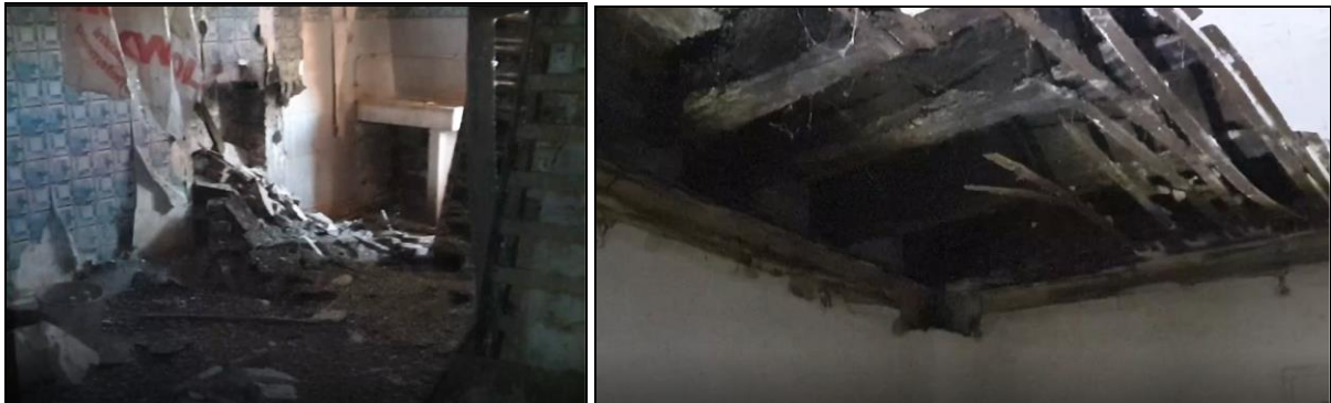
Effondrements des planchers + cheminées.
